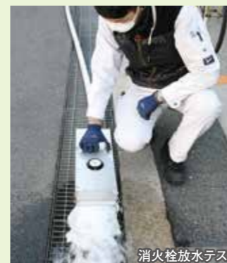
消火栓放水テスト
