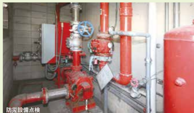
防災設備点検
